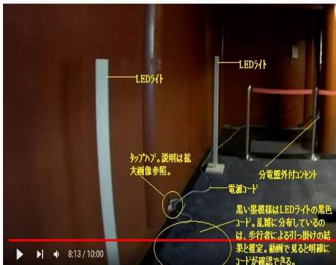
【図3】分電盤室内の機器・配線の状況・南側から北側壁面に向かって見た画像[2]
